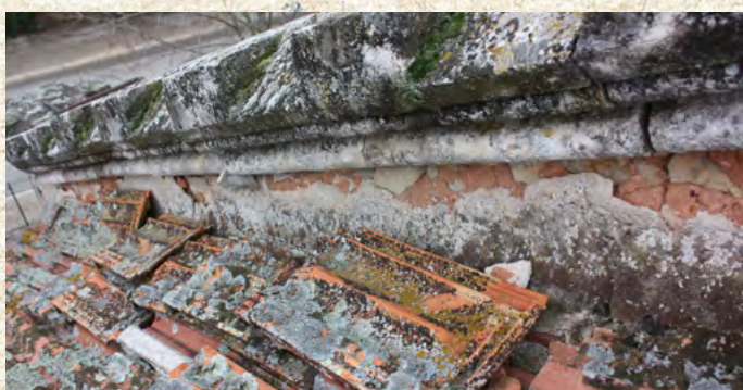
8. Etat du solin côté façade.
