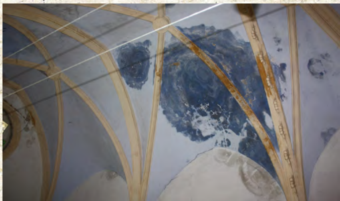
5. Les taches sur les voûtes intérieurs.
